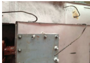
koordpakking ter afdichting van oven
