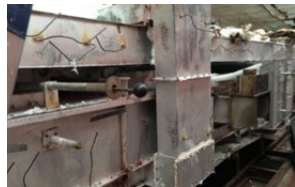
Asbest pakkingen in installatie
