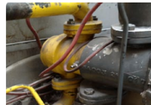
pakkingen in installatie (gasstraat)
