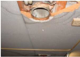
ontluchtingskanalen en ventilatieroosters
