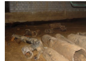
oude rioolleidingen in kruipruimte
