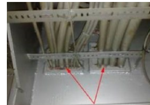
afdichting bij kabeldoorvoer
