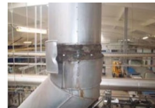
koordafdichting in kanalen (rookgas, wasem en gasafvoer). De isolatie onder de aluminium schalen kan ook asbest bevatten
