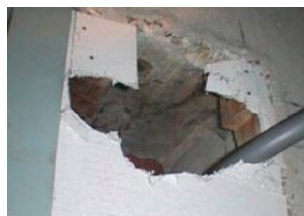
kabeldoorvoer / brandcompartimentering. Beplating heeft een honinggraat structuur
