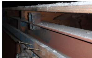
Beschadigd brandwerend materiaal
