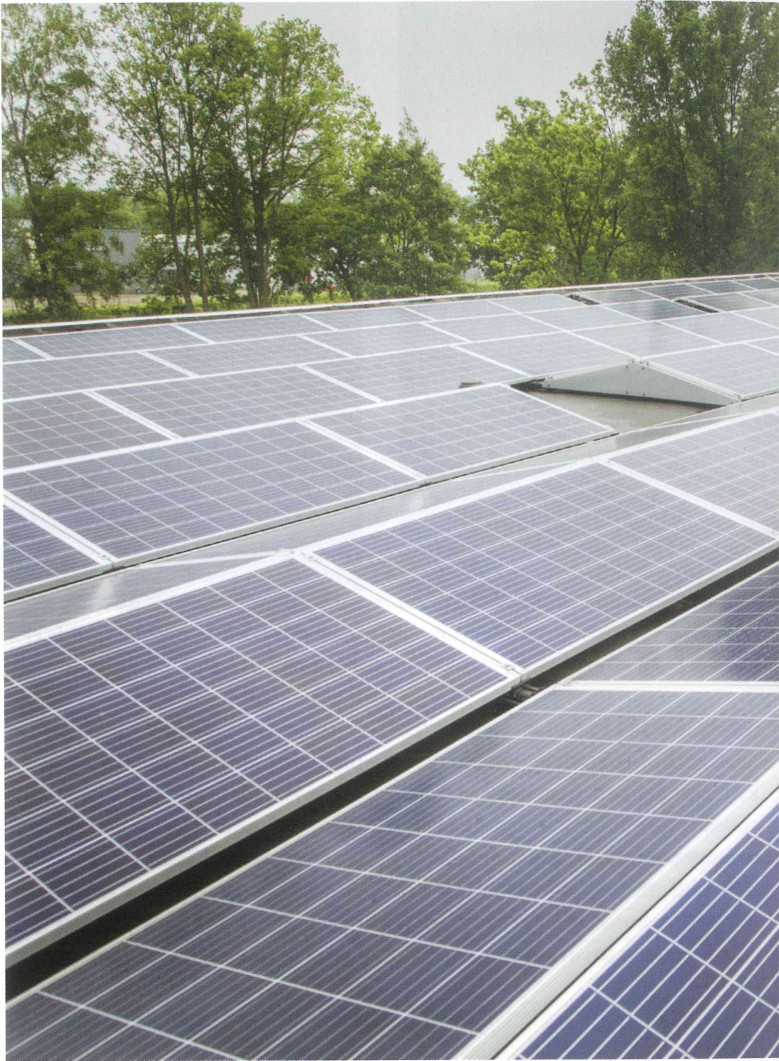
Bij Fuite liggen 902 zonnepanelen op het dak.
